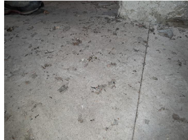
Abb. 12: Fledermauslosung auf Dachstuhl des Hauses Am Wiedenhof 17 (ISR 2025)
