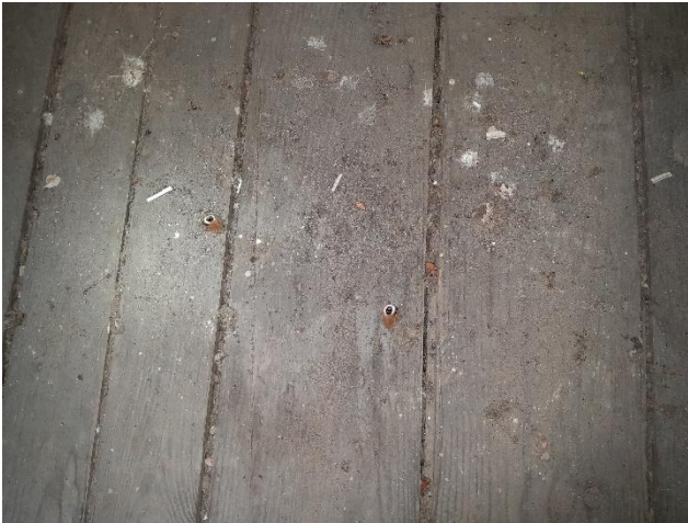
Abb. 11: Insektenteile und Kots Spuren auf Dachstuhl des Hauses Am Wiedenhof 9 (ISR 2025)
