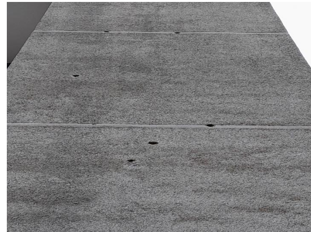
Abb. 12: Spechtlöcher in Verkleidung des Fahrstuhlschachtes (ISR 2025)
